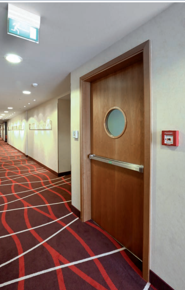
^ Baurechtlich nicht vorgeschrieben, aber im Notfall Leben rettend: Push-Bars und Panikstangen an Türen im Verlauf von Rettungswegen. Foto: Steffen Füssel / vor-ort-foto.de
